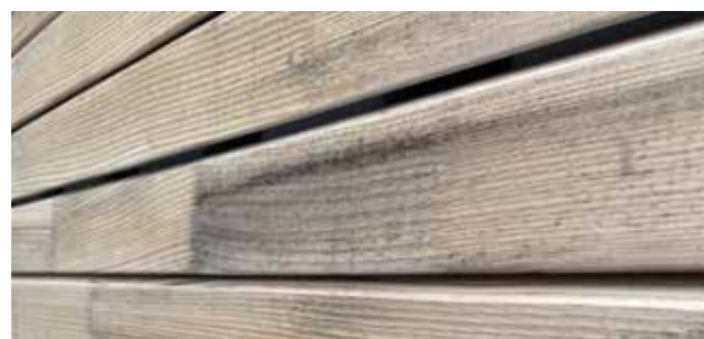
○ Weißtanne, keilgezinkt. Auftritt von harmlosen Bläuepilz, welcher die Qualität des Holzes nicht beeinflusst. Mit der Zeit wird das Holz durch den natürlichen Vergrauungsprozess in einen grauen/dunkelgrauen Farbton übergehen. Das Bild zeigt also einen Zwischenschritt
